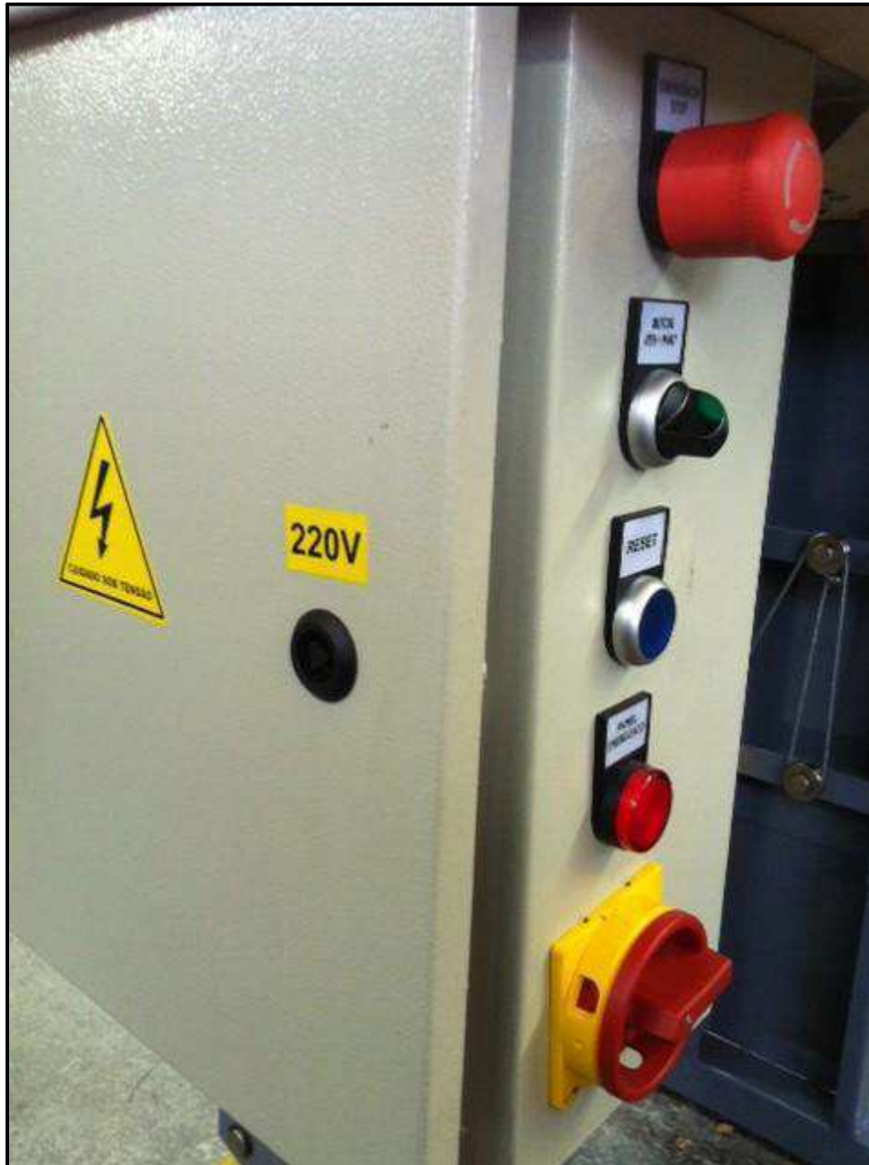
Figura 2 - Identificação de Perigo Elétrico do Quadro de Comando
